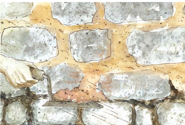
▲ Rejointoiment sur un mur en granite. Les joints sont « beurrés » c'est-à-dire bien garnis. Après le rejointoiment, on peut brosser les pierres pour les nettoyer : on évitera les joints qu'il ne faut surtout pas creuser.
